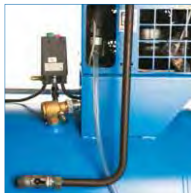
Instalované výrobce a vše již připojené
